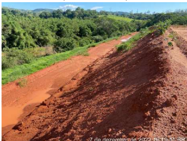
Foto 154 – Vista para cacimba de retenção de sedimento. (Data:07/12/2022)
