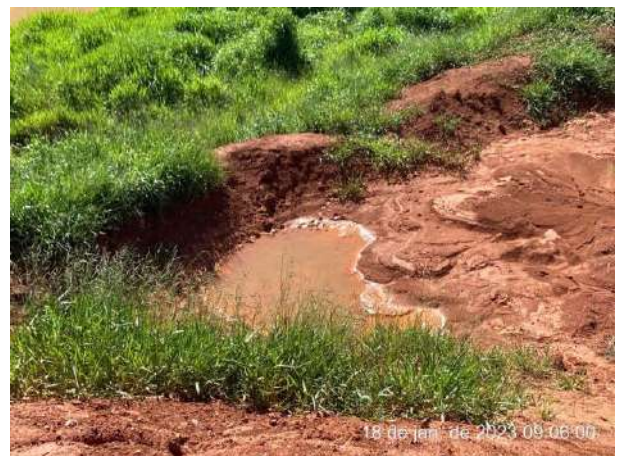
Foto 161 – Vista para cacimba de retenção de sedimento. (Data:18/01/2023)
