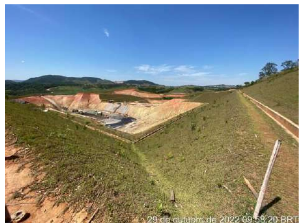
Foto 192 – Grama e canaleta de drenagem. (Data:29/10/2022)
