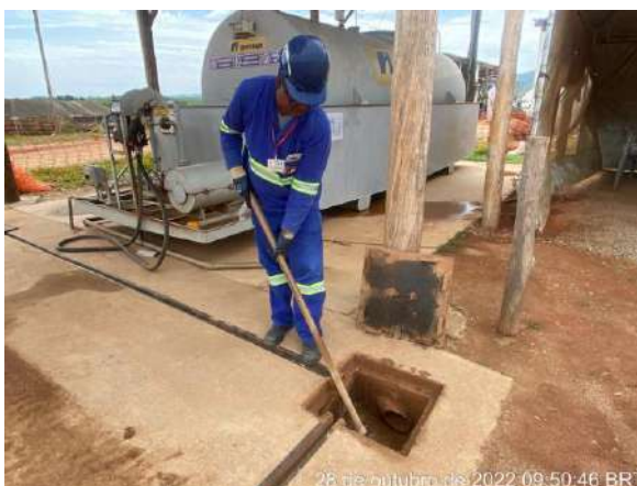
Foto 204 – Manutenção e Limpeza das canaletas e caixa de inspeção na área de abastecimento de combustível. (Data: 28/10/2022)
