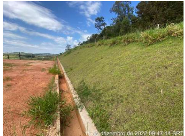
Foto 196 – Grama e canaleta de drenagem. (Data:15/12/2022)
