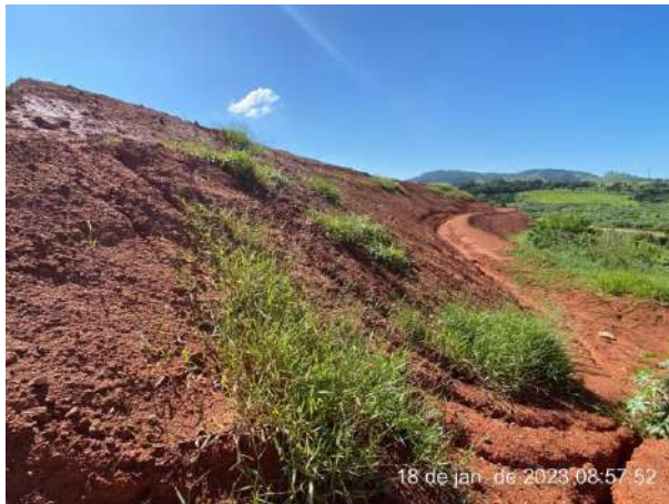
Foto 158 – Vista para leira e inclinação e direcionamento para saída do talude. (Data:18/01/2023)
