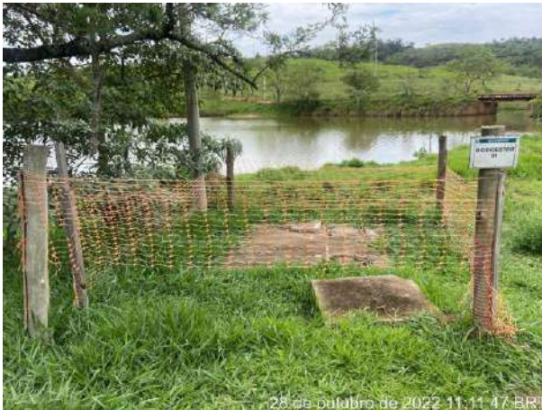
Foto 210 – Biodigestores do canteiro administrativo. (Data: 28/10/2022)
