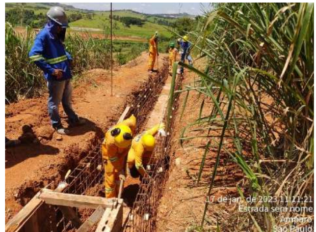
Foto 198 – Grama e canaleta de drenagem. (Data:17/01/2023)
