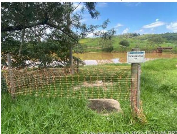
Foto 212 – Biodigestores do canteiro administrativo. (Data: 15/12/2022)
